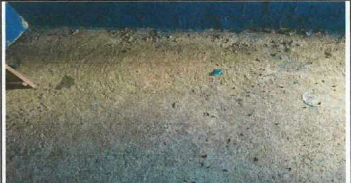
Foto 4: PISO DE CONCRETO REQUIERE CAMBIO
