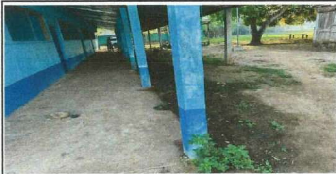
Foto 5: SUSTITUCION DE PISO EN MAL ESTADO
