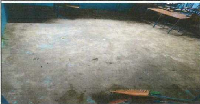
Foto 3: PISO DE CONCRETO EN MAL ESTADO
